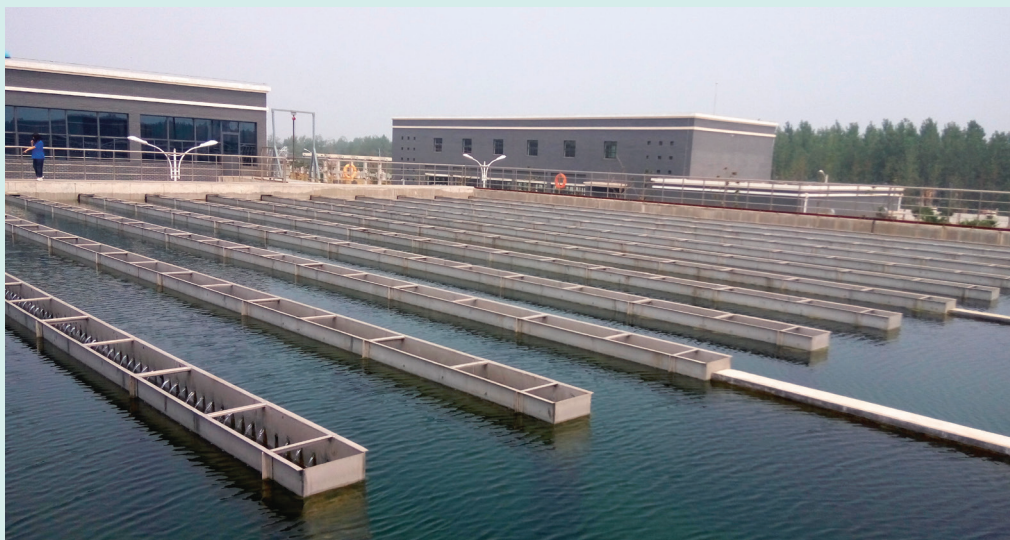
Imagem 6 – Estação de Tratamento de Água
