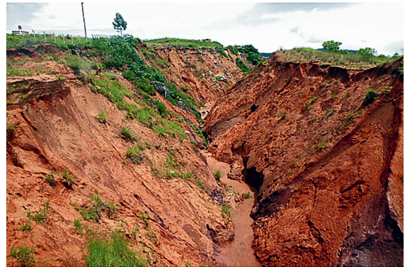
Imagem 4 25 . Boçoroca causada pelo escoamento de águas pluviais na região de Piracicaba (SP)
